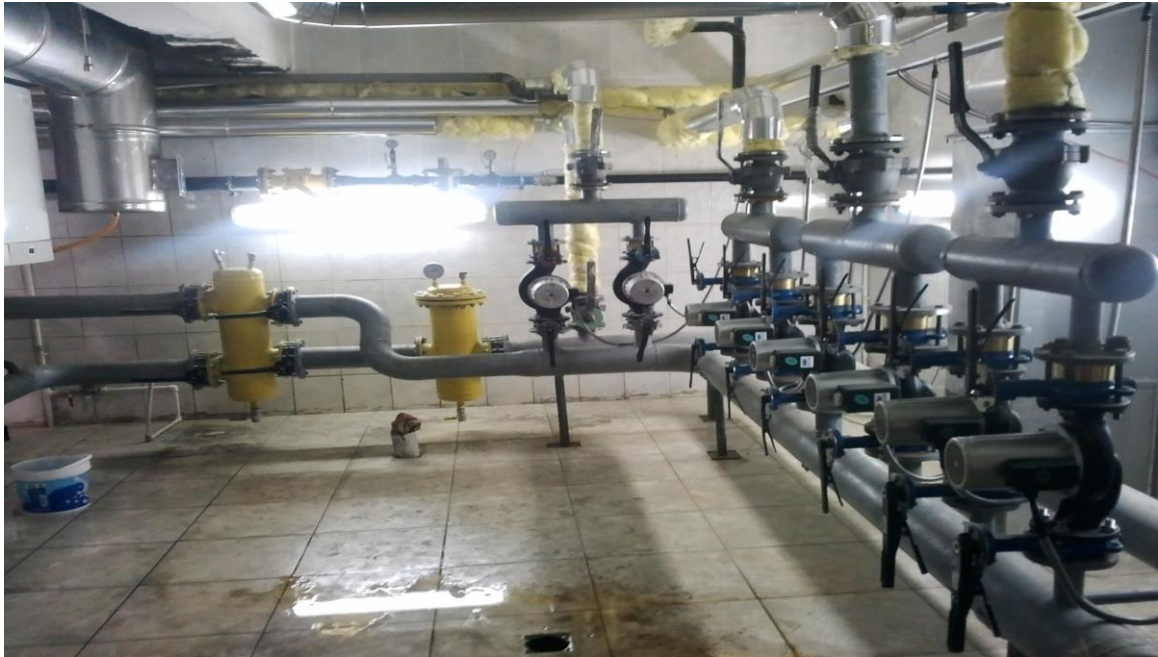
Bolu Milli Eğitim Müdürlüğü Doğalgaz Dönüşümü
