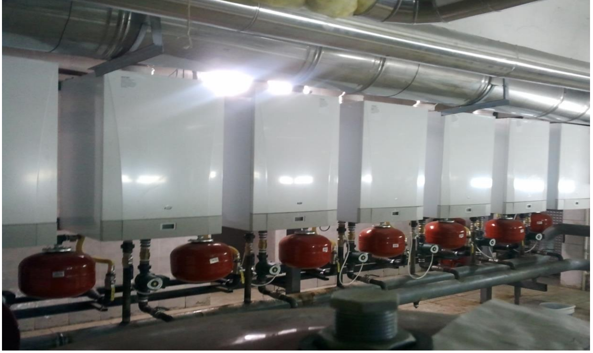
Bolu Milli Eğitim Müdürlüğü Doğalgaz Dönüşümü
