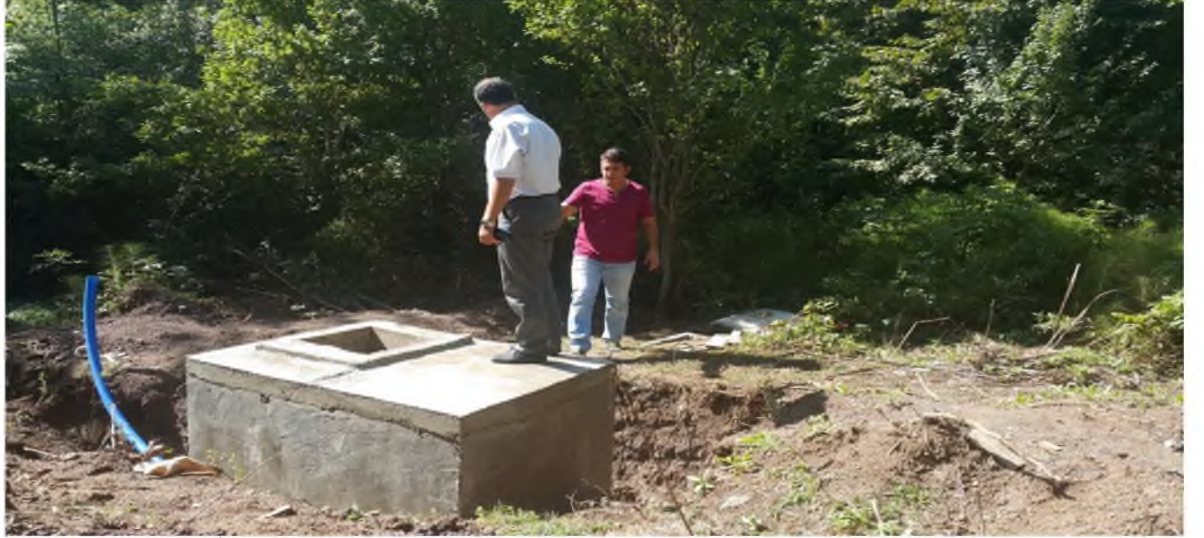
Yeniçağa İlçesi Kındıra Köyü Hasanağalar köyü içmesuyu projesi kaptaj görüntüsü.
