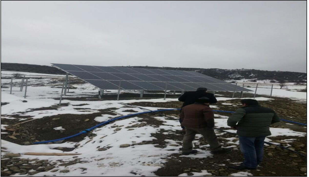
Göynük Kilciler İçmesuyu Terfili sistem Güneş Enerji Paneli Görünümü
