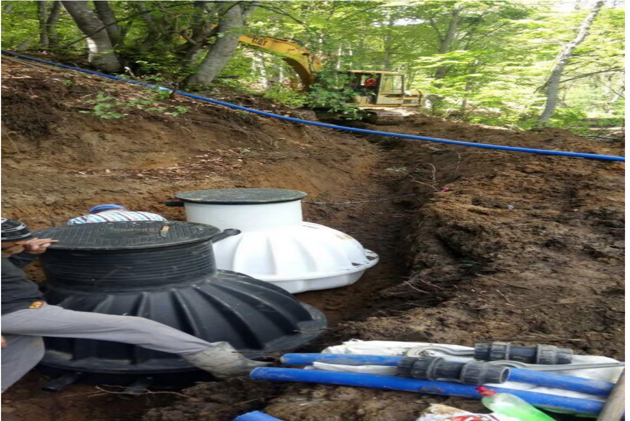
HDPE 100 Kaptaj Görünümü
