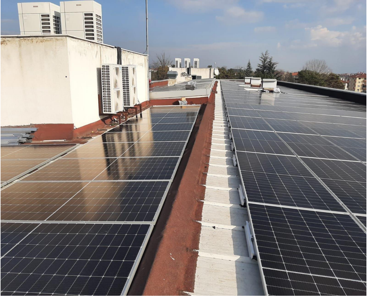
Bolu İl Özel İdaresi Bina Çatısı ve 240kw Güneş Enerji Santrali
